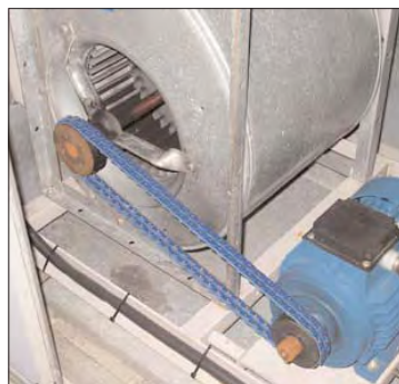
Aria Condizionata Base Navale
